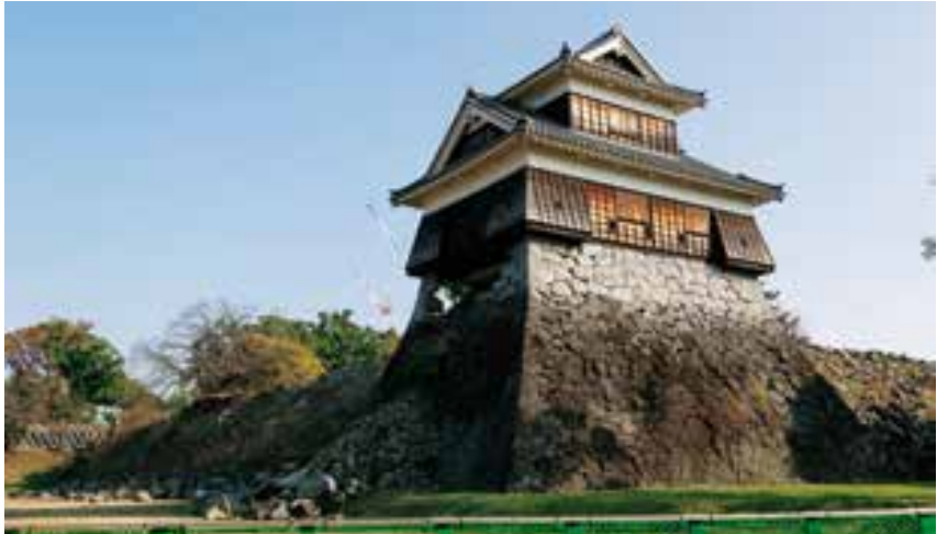
複数箇所石垣が損壊(写真は戌亥櫓)
