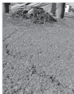
▲駐車場の下に根 を張りアスファ ルトにヒビが。
