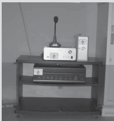
▲洗川地区の放送設備
