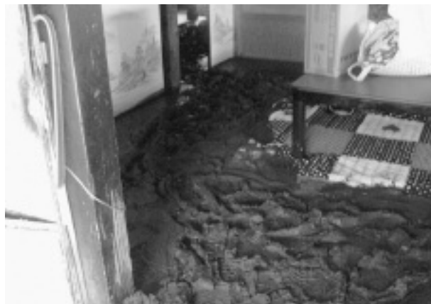
▲上色見中原地区では住居内に濁流が流れ込み、床上浸水などの深刻な被害
