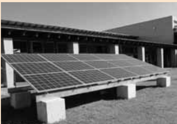
▲高森中学校の中庭に設置された太陽光パネル
