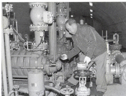
高森トンネルポンプ場で機械を点検する渡邊さん
