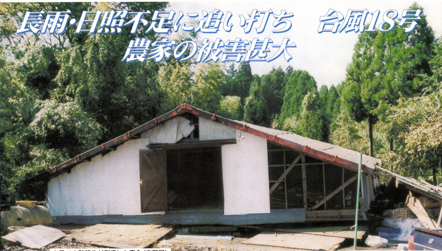
台風で1階部分が倒壊した畜舎(市野尾)
