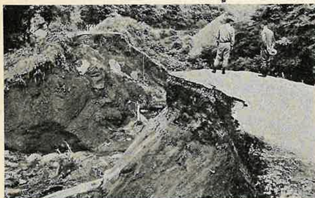
国道325号線の猿丸一柳谷間は暗きょうが流されて車も通行止め
